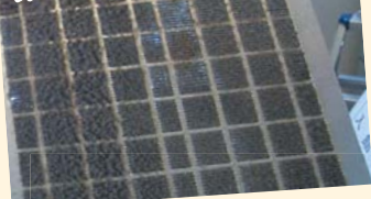
目地に油がつまり、ホコリが付着。これではしっかり換気できません。
